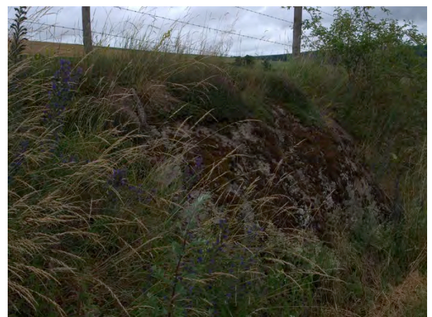
Figure 52. Aspect du talus schisteux en bordure de la route de Forrières à Wavreille (rue de France).
